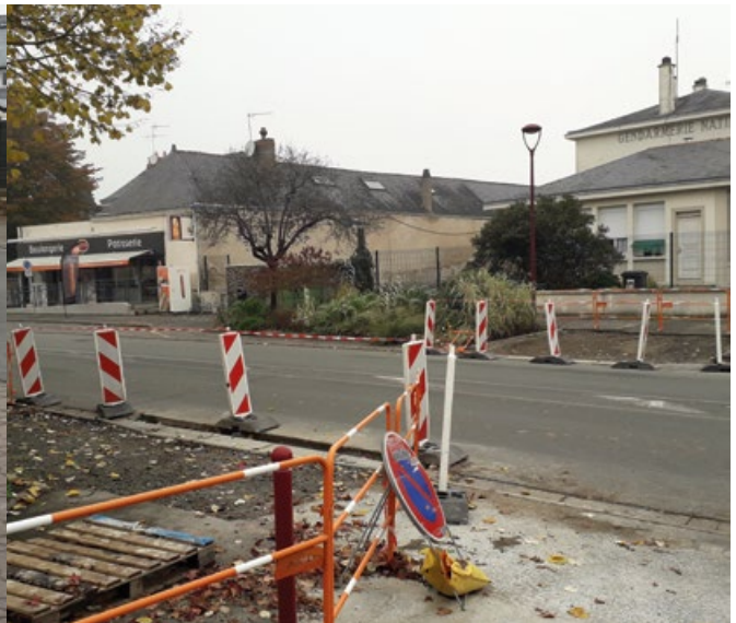
Rues du Tertre et Nationale, sécurité et accessibilité sont les mots d'ordre des travaux engagés.
